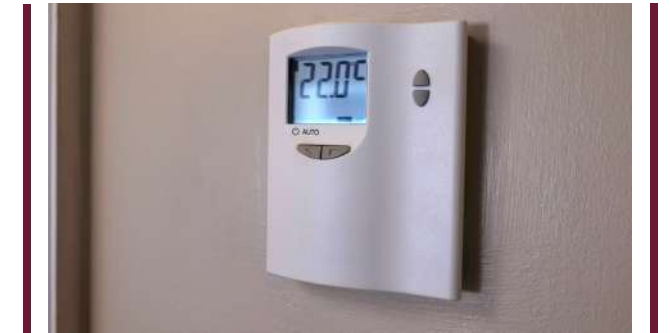
Control del sistema de refrigeración y ventilación
