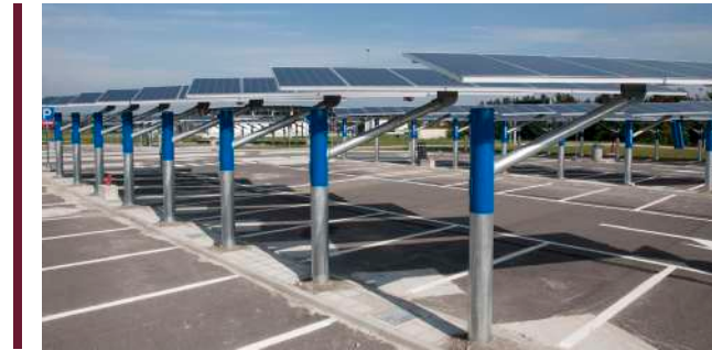
Paneles fotovoltaicos sobre cubierta de estacionamiento
