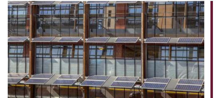
Panel fotovoltaico instalado en la fachada del edificio.
