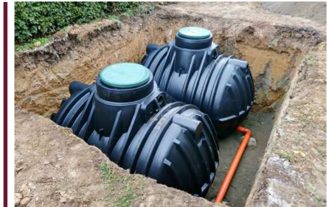
Tanques para captación de agua de lluvia
