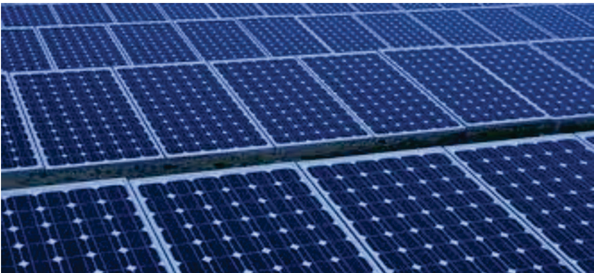
Figure 117 : Exemple d'un champ photovoltaïque
