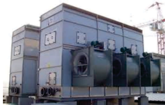
Figure 80 : Ventilateurs centrifuges montés sur tour de refroidissement
