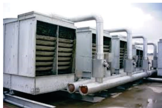
Figure 81 : Série de pompes montées sur un système de refroidissement
