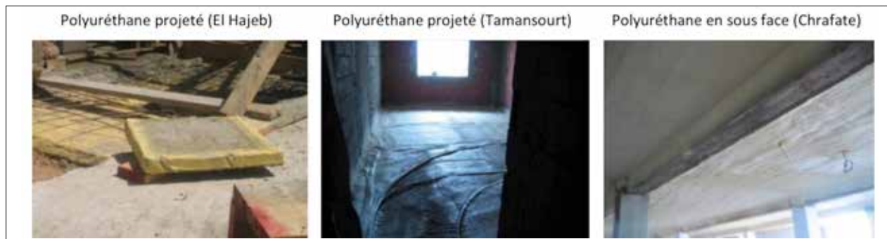
Figure 43 : Isolation des planchers
